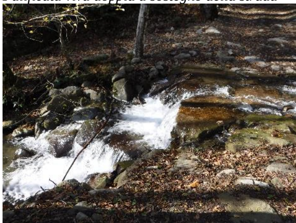
Guado a ruota bagnata con step-pool a valle – opera permeabile alla risalita dei pesci
