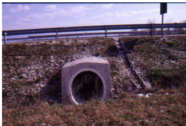
Foto 516 – Passaggio per fauna a tubo (Collegamento Cimpello – Sequals – PN – Foto G. Sauli)
