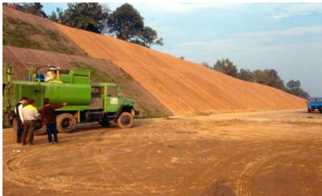
Foto 462 - Stuoie in cocco su scarpate in scavo in litologie sabbiose non sempre hanno assolto alla funzione di stabilizzazione essendo dei provvedimenti antierosivi (Autostrada dei trafori – ottobre 1988 – Foto G. Sauli)
