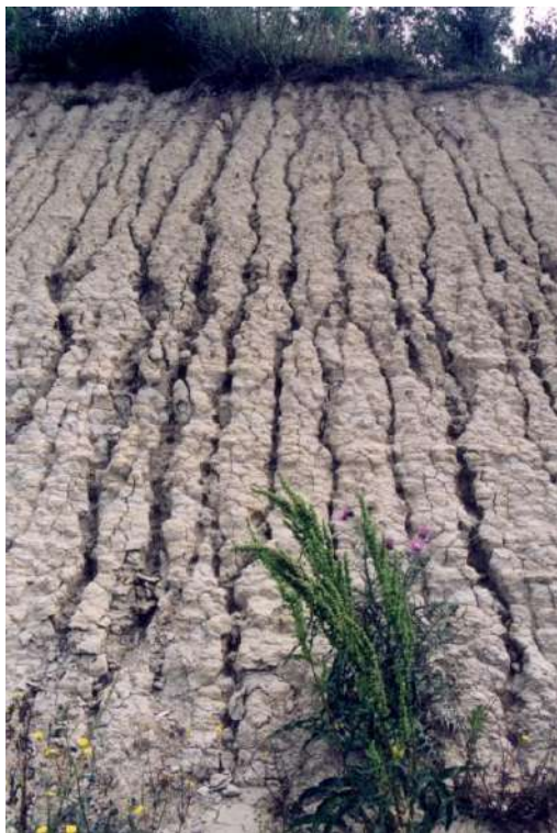
Foto 417 - Inizio di solchi di erosione su scarpate non rivegetate in trincea in litologia sciolta a matrice argillosa. (3° corsia autostrada Orte-Fiano Foto G. Sauli)
