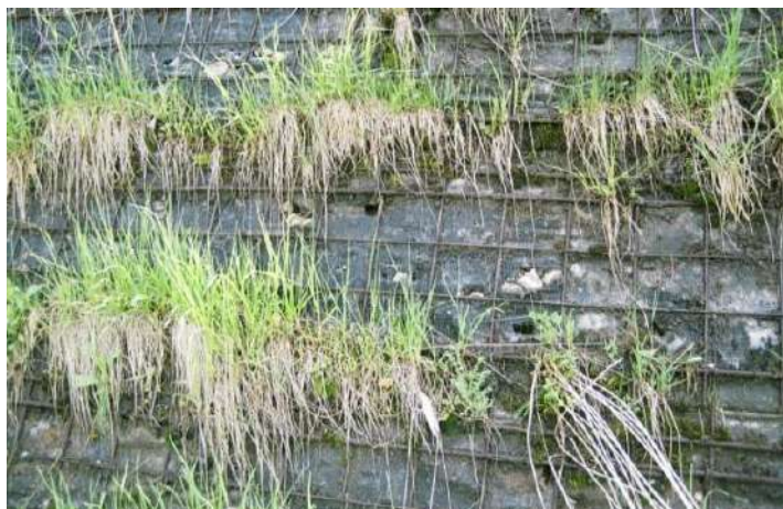
Foto 467 - Evidente assenza di terra vegetale e stuoie inadeguate limitano la crescita delle erbe alle strisce di contatto tra gli strati delle armature orizzontali (Foto G. Sauli)
