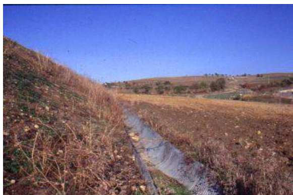
Foto 439 – Canaletta in metallo con problemi di sifonamento (Foto G. Sauli)
