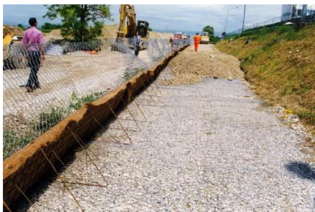
Foto 470 - TRV con rinforzi orizzontali in rete metallica (A4 Casello di Villesse – Foto R. Ferrari)
