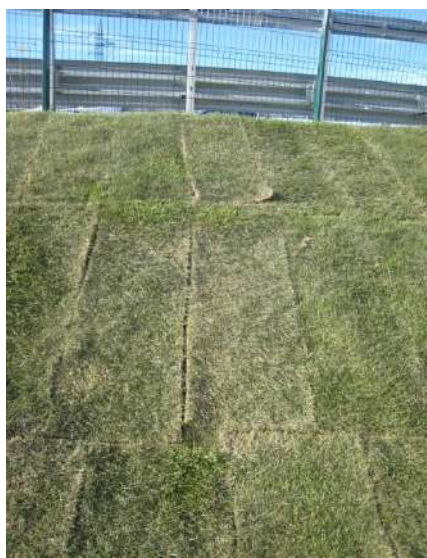
Foto 4294 – Rivestimento di scarpata con prato in rotolo con problemi iniziali di possibili scollature (Grande viabilità Trieste zona Padriciano - Foto G. Sauli 2008)
